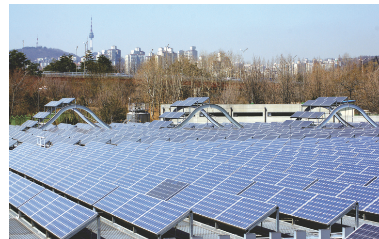
서울숲에 설치된 태양광 발전소
