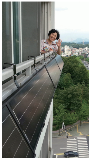
아파트 미니태양광 설치
