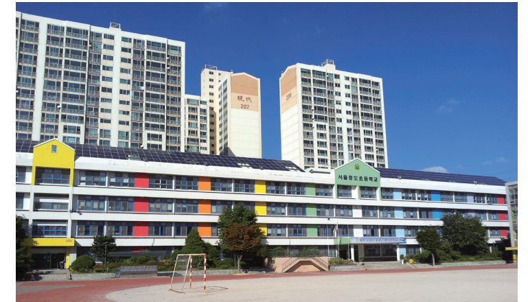
창도초등학교 옥상에 설치된 태양광
