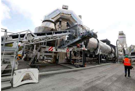
[그림 1] 이동식 아스콘 재생 공장
