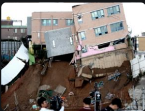
용산 건물 붕괴 (2018. 06)
